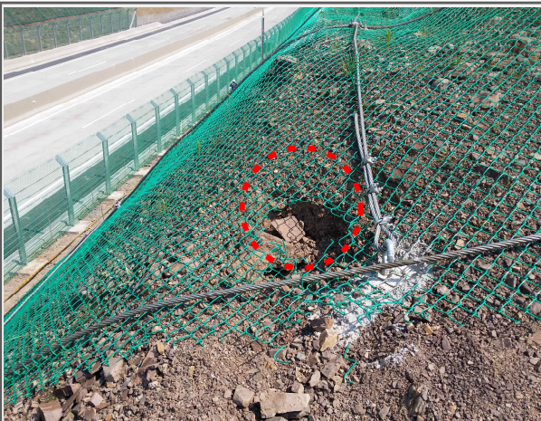
③ Sta.6+460부근(상주) 낙석방지 능형망 설치 파손
