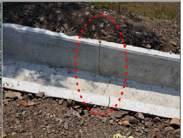
④ Sta.6+420부근(상주) 산마루 측구 배수로 균열 발생
