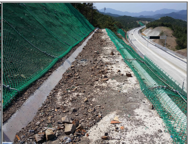
⑥ 20m 소단 배수로 파쇄암편 청소 불량
